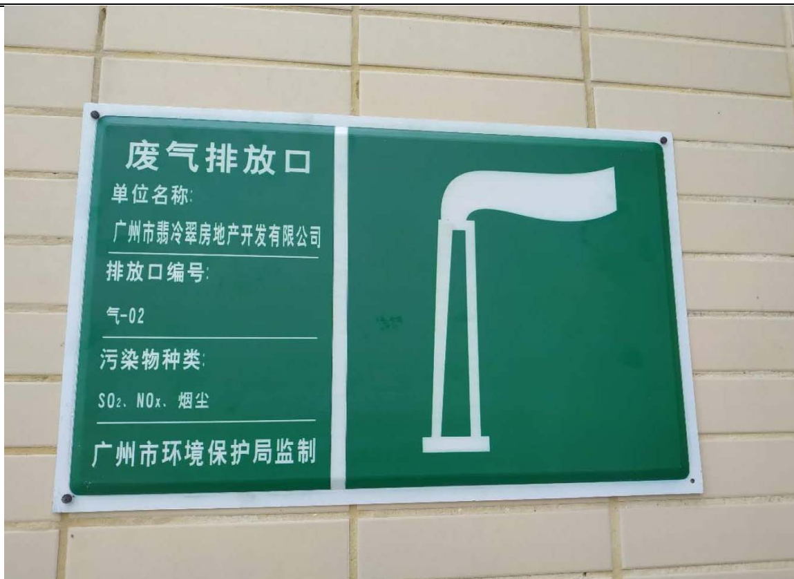
发电机尾气排放口：气-02（近照）
