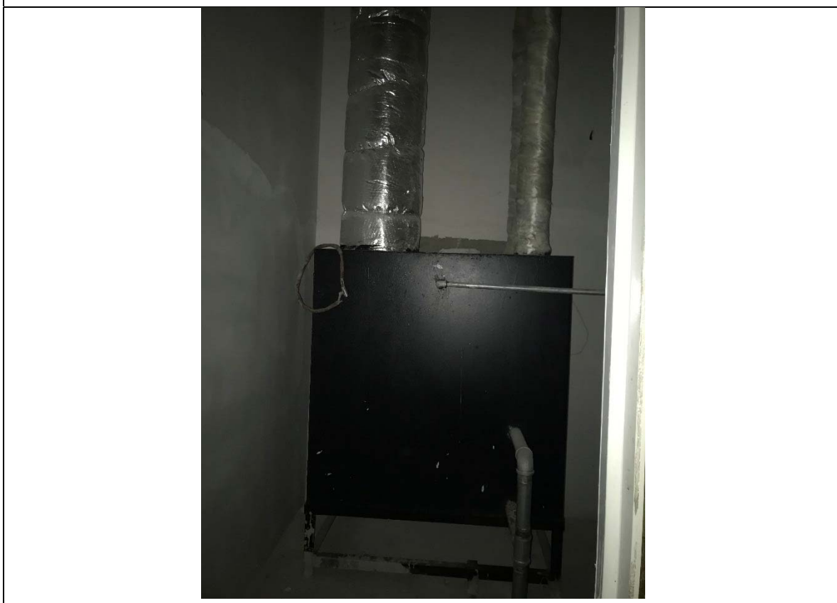
1号发电机水喷淋设施
