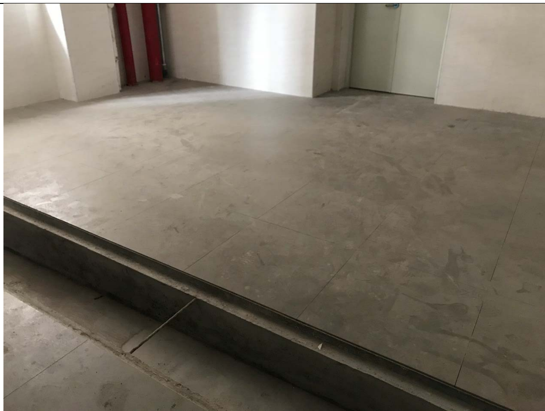
幼儿园厨房排水
