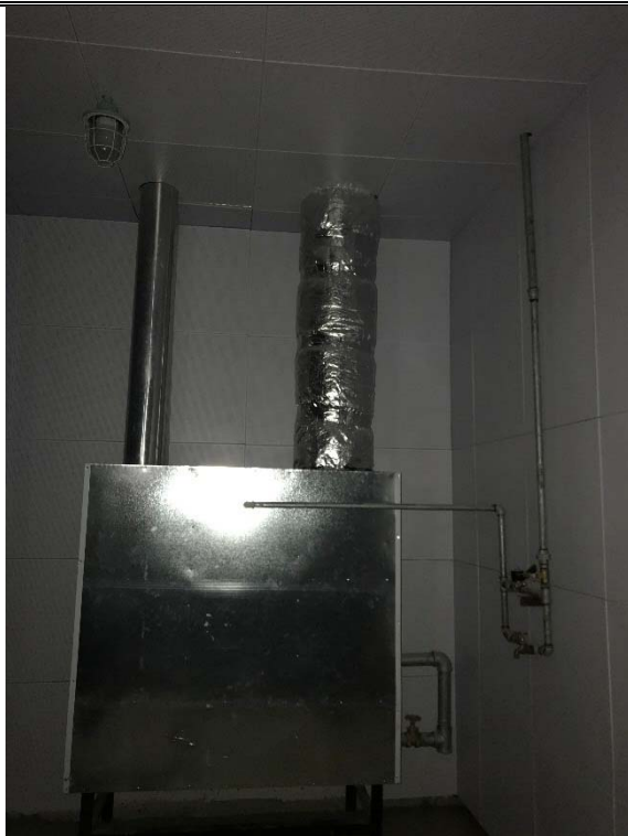
2号发电机水喷淋设施
