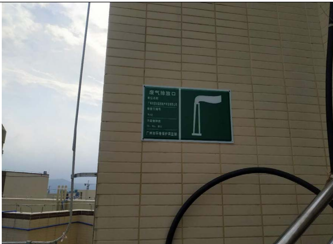
发电机尾气排放口：气-02（远照）
