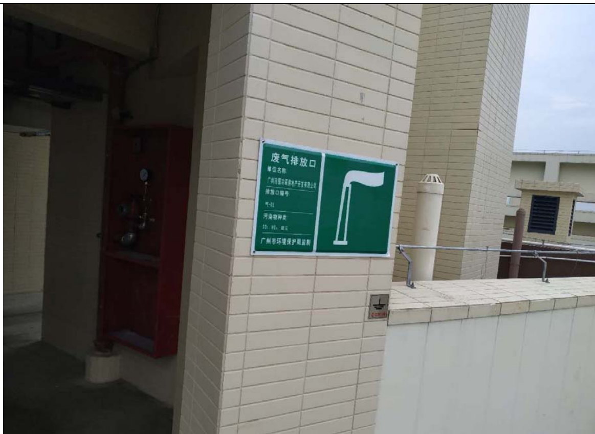
发电机尾气排放口：气-01（远照）
